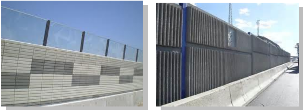
Rajah 24 : Noise Barrier
